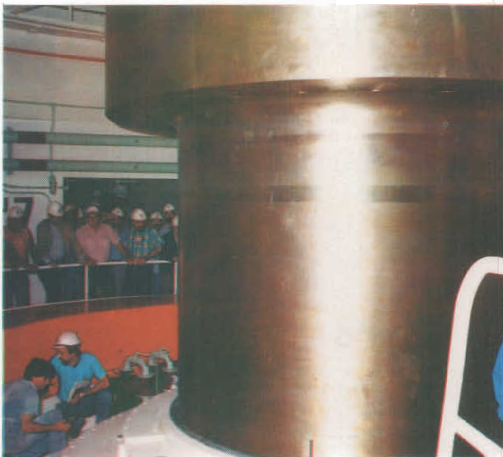
Operación del 1er. giro mecánico de la unidad generadora n° 7 (50 Hertz) realizada el 07.10.87.
