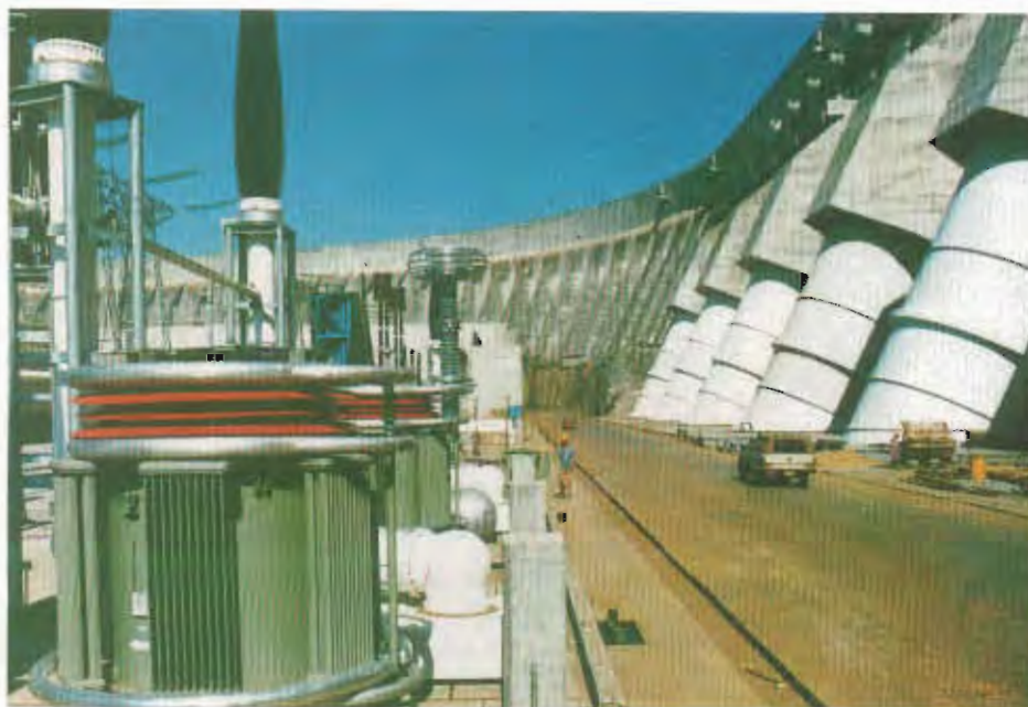
Vista de la Central Hidroeléctrica de Itaipú, aguas abajo de la presa principal, donde se observan equipos e instalaciones relacionados con la salida de la energía producida.
